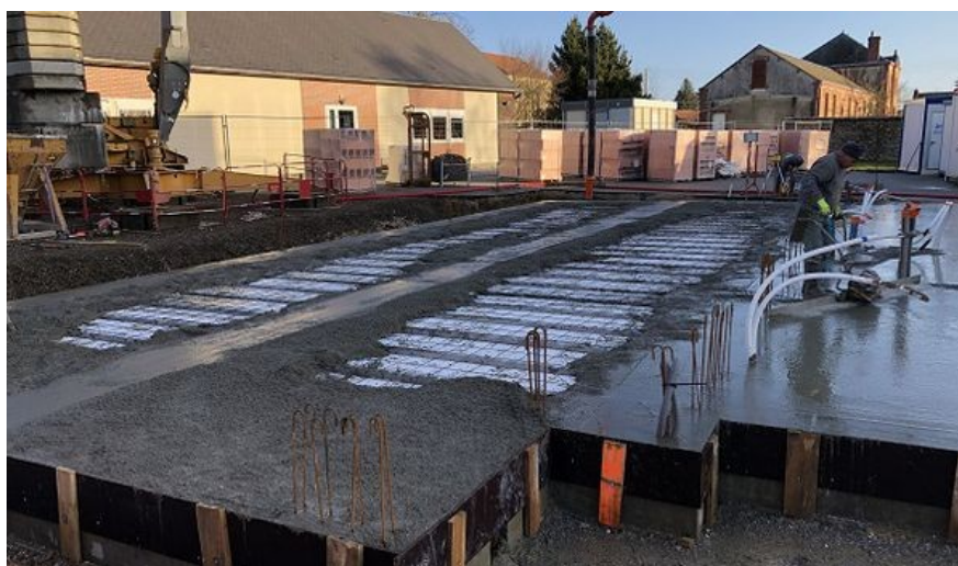
28. La Bazoche-Gouet. Lance ment de la construction de la bibliothèque. Source : http://www.labazochegouet.com/
