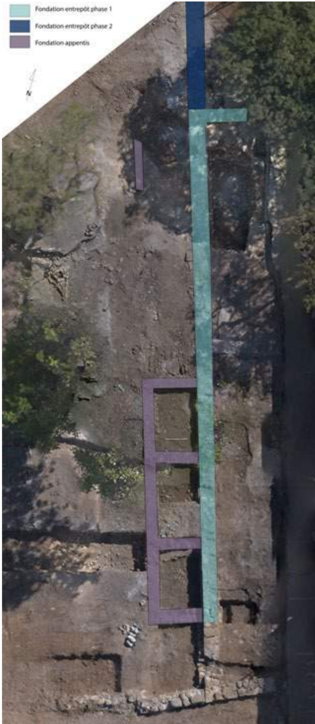
[Fig. 4]: Les fondations du grand entrepôt et de ses appendis (photo A. Vaccaro / Agence Wopé !, DAO M. Baffert)
