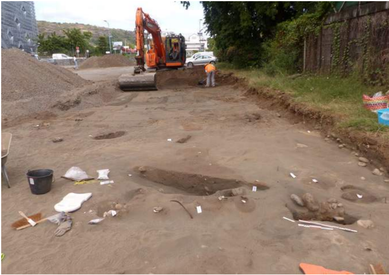
[Fig. 4]: Décapage des niveaux superficiels pour faire apparaître les vestiges (photo M. Folgado-Lopez / Inrap)
