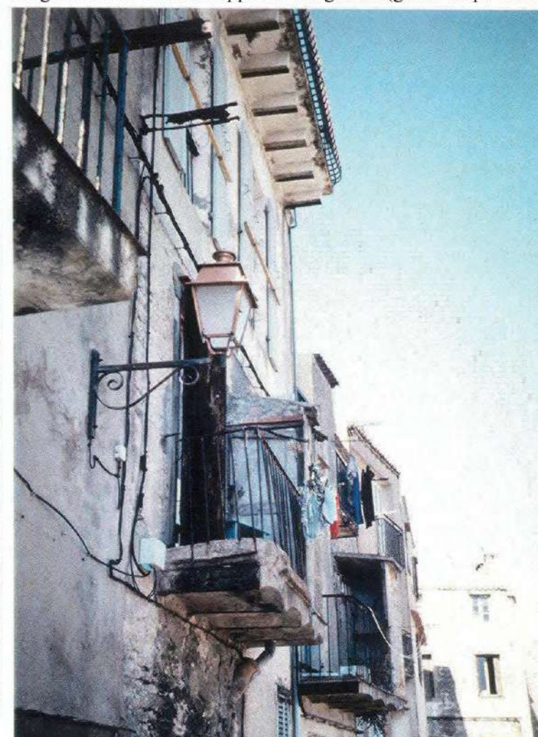
Alignement de balcons rapportés dangereux (garde-corps et IPN rouillés)
