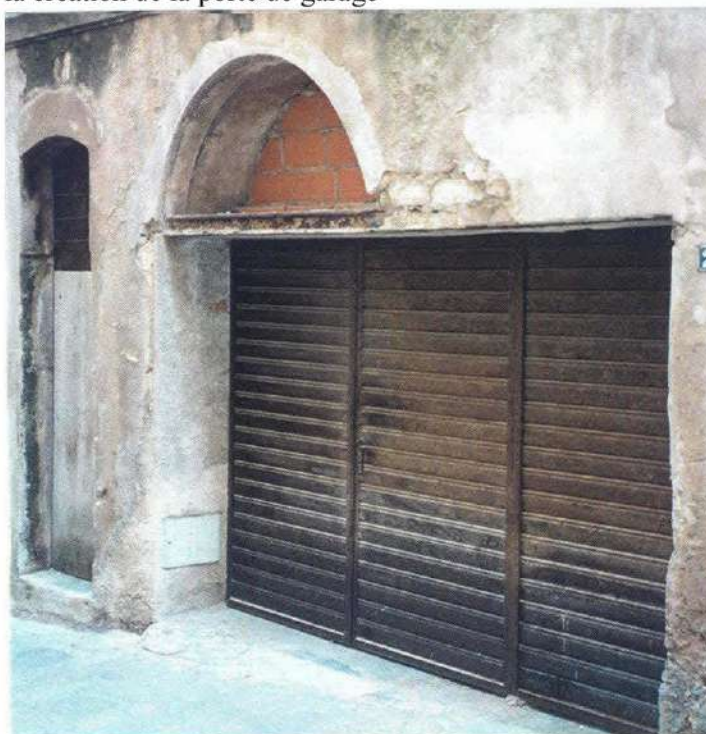
Ouverture cintrée détruite pour la création de la porte de garage
