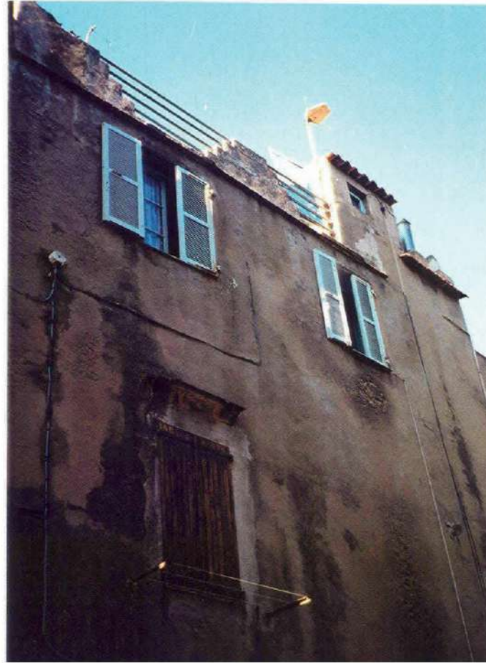
A - B - C : état de dégradation du bâti de la ville haute
