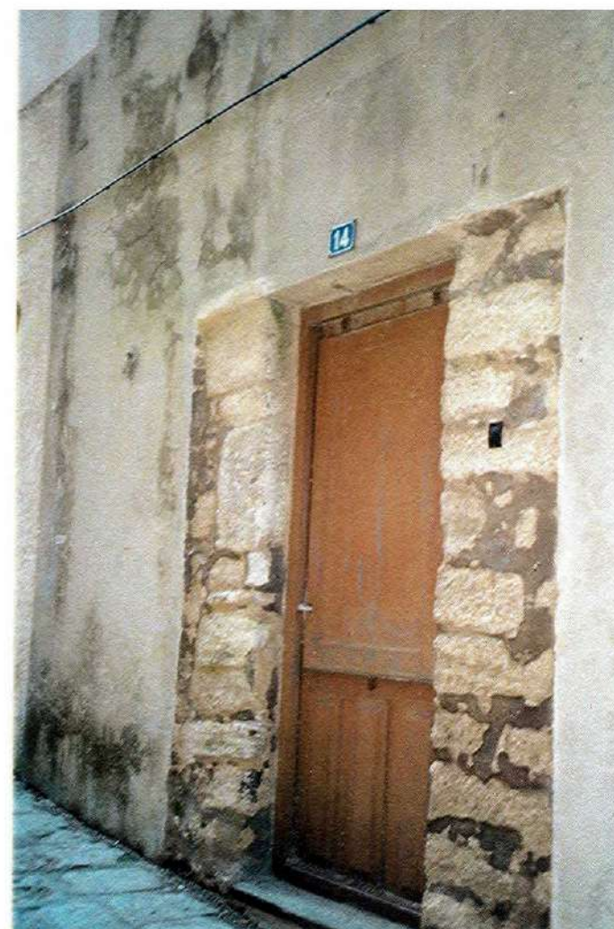
Mauvais exemple de traitement de maçonnerie ancienne cimentée
