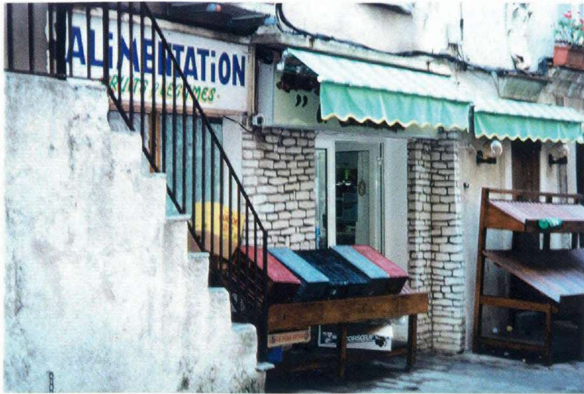
Rez de chaussée modifié, moëllons de calcaire “rustiques” inadaptés La façade gagnerait à être enduite
