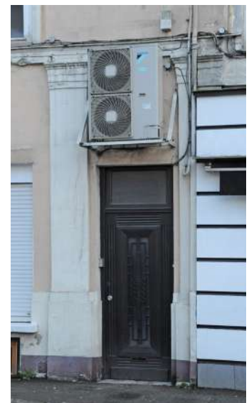
Installation inappropriée de pompes à chaleur en façade (exemple hors région).
