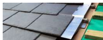
Exemple de capteurs solaires intégrés sur une toiture en ardoise par la couleur, l'encastrement et la position.
