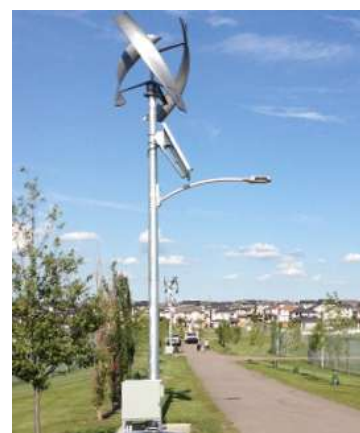
Éolienne à axe vertical, couplée à un panneau photovoltaïque pour l'éclairage public.
