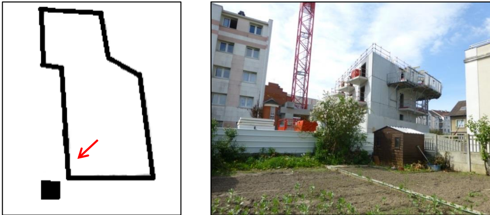
Figure 24 – Immeuble en cours de construction à l’emplacement de l’ancienne maison du gardien, mai 2015.
