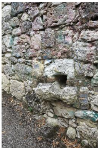
Fig. 8 - Mur de clôture ouest (bouche d'évacuation dans le carrelot).
