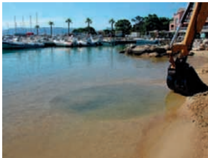
Fig. 108. Port de plaisance Jean-Baptiste Tomi, Serra di Ferro, opération d'évaluation du potentiel archéologique de la zone du port, sondage à la pelle mécanique (cl. F. Cibecchini).
