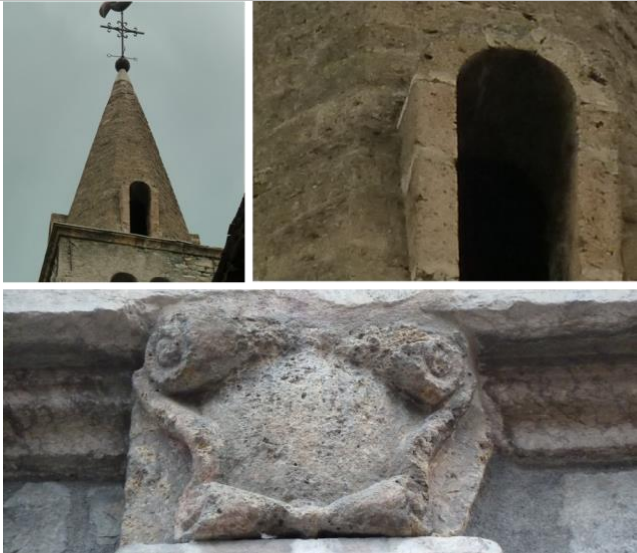
Vues de mise en œuvre du tuf calcaire beige-crème plus ou moins vacuolaire.
