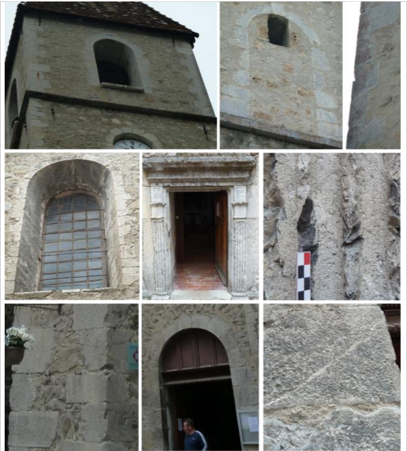
Vues extérieures de mise en œuvre du calcaire dur noir, à pâte fine (marbrier) et patine gris-clair, entrecoupé de veines blanches de calcite.
