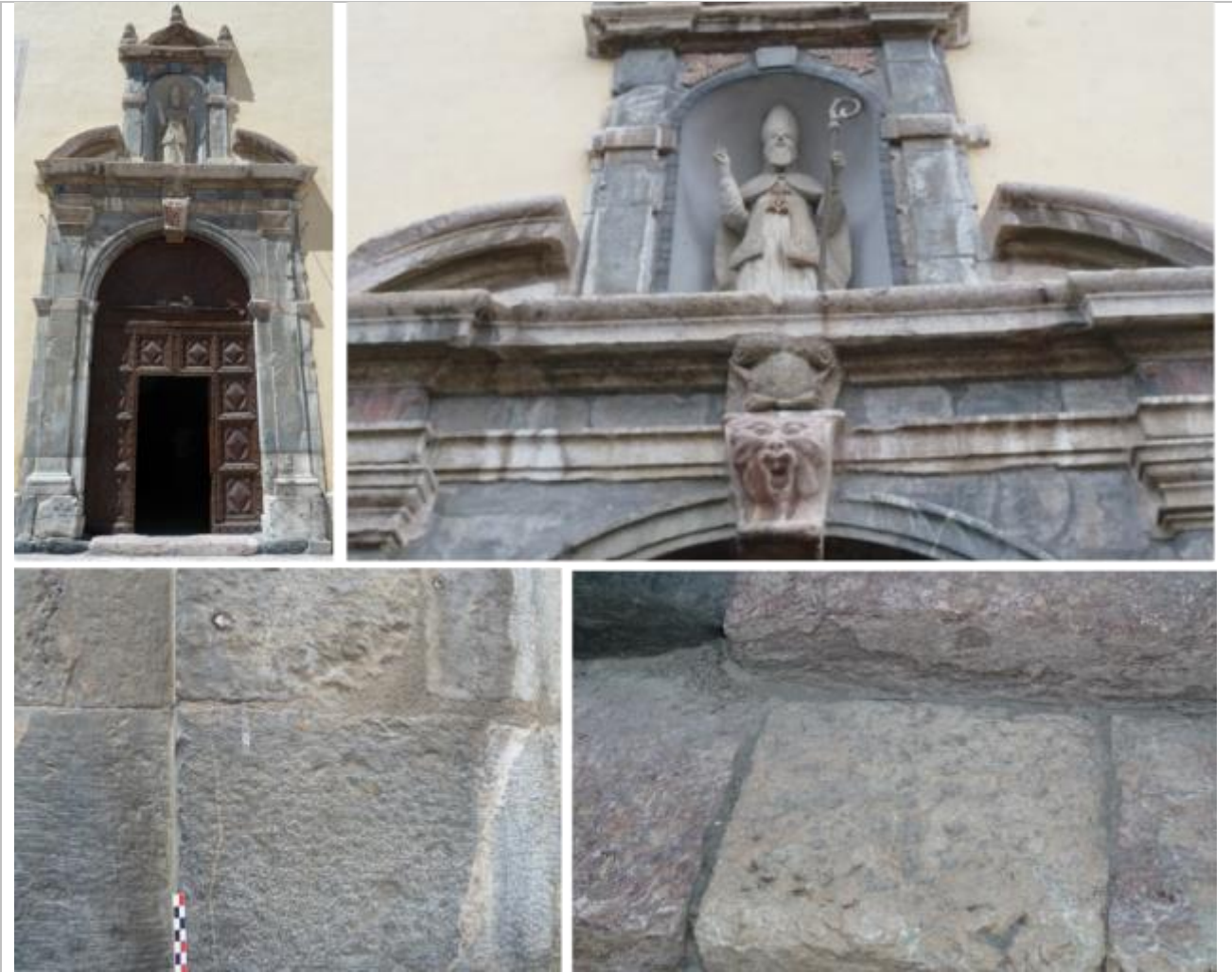
Vues du portail en calcaire noduleux rouge et du calcaire gris à veine blanche de calcite.
