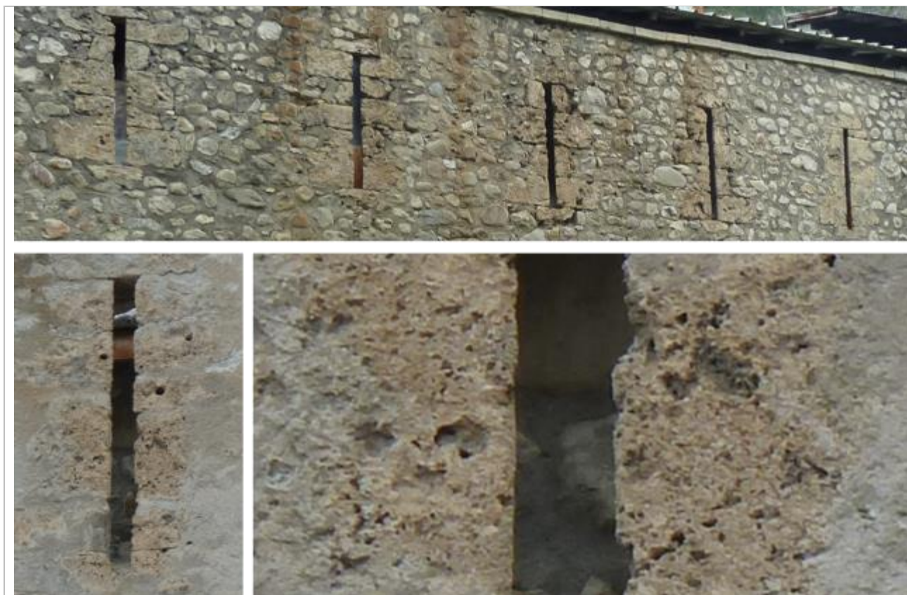
Vues de mise en œuvre au niveau du clocher du tuf beige-ocre vacuolaire.
