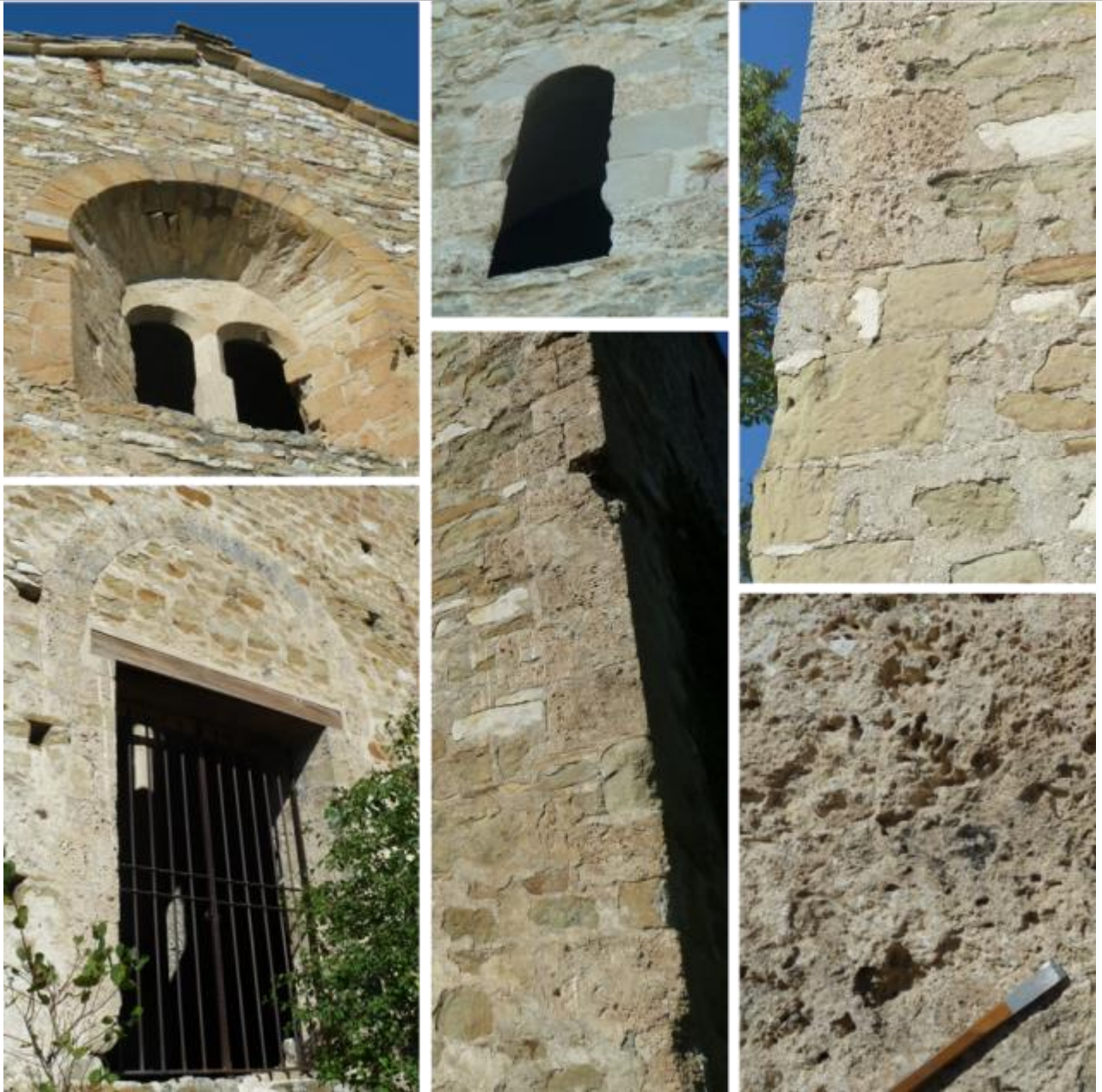
Vues de mise en œuvre de blocs taillés de grès beige-verdâtre en mélange avec du tuf de source beige-crème plus ou moins vacuolaire à patine beige-grisâtre.
