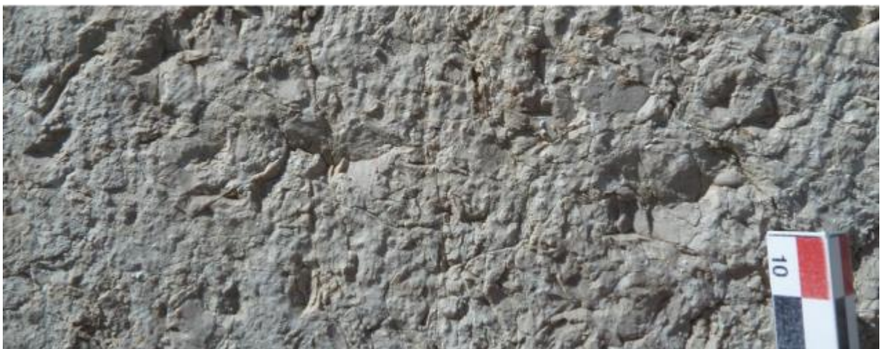
Vues de mise en œuvre du calcaire dur gris-brun à patine gris-clair légèrement rosé, à pâte fine plus ou entrecoupée de veinules blanches de calcite pouvant lui conférer un aspect bréchiue.
