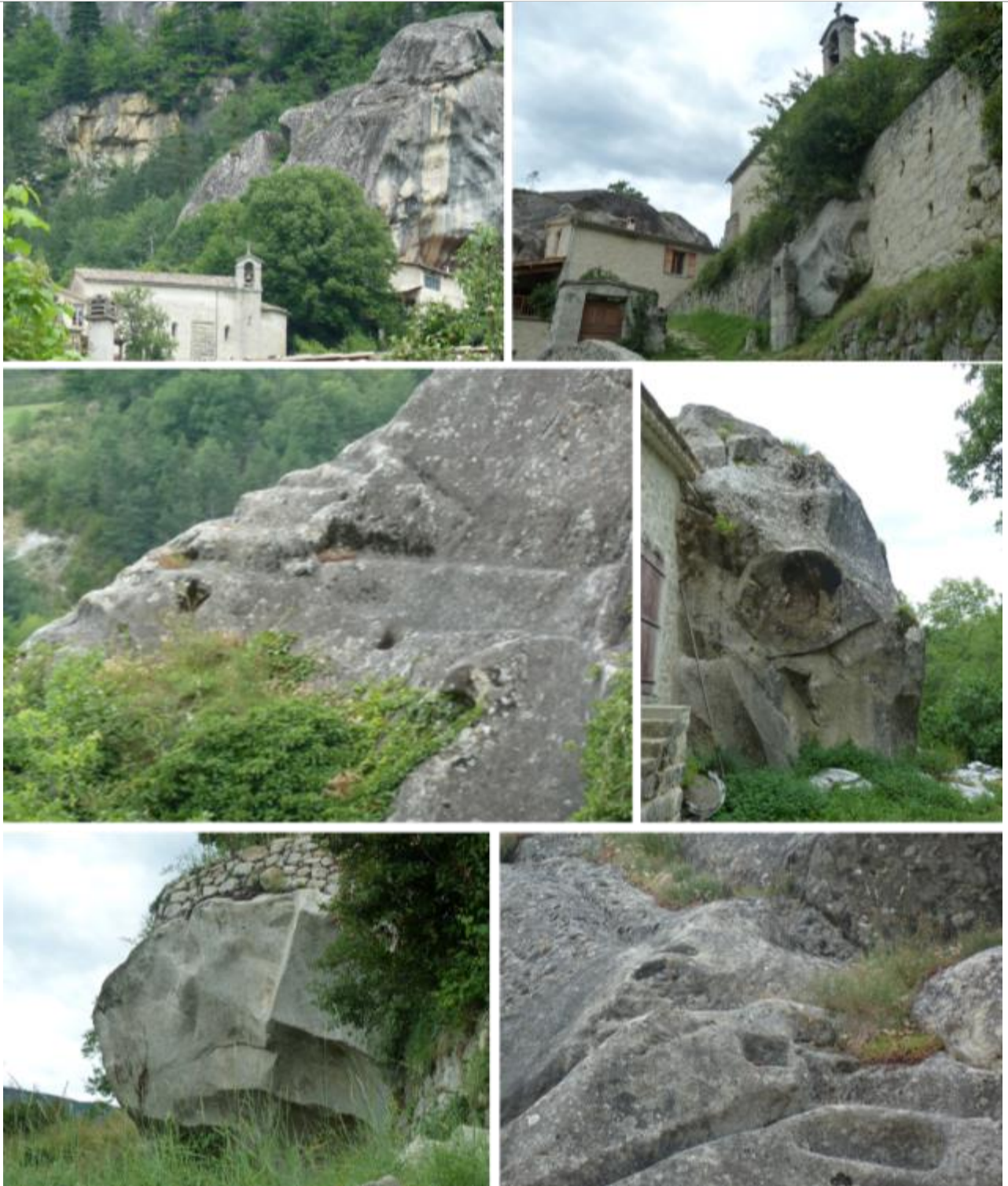
Vues des blocs de Grès d'Annot de plusieurs dizaines de mètres-cubes détachés des barres rocheuses sus-jacents.
