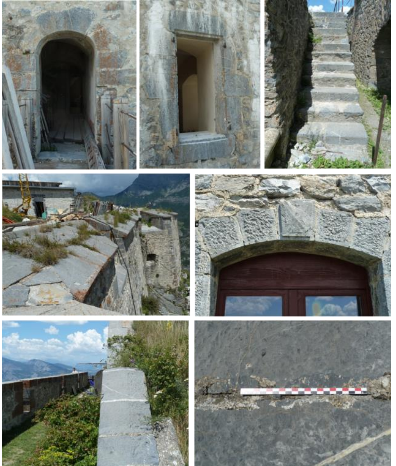
Vues de mise en œuvre du calcaire dur et compact (marbrier) noir à pâte fine, à passées bréchiques, plus ou moins entrecoupé de larges veines blanches de calcite, à patine gris-bleu.
