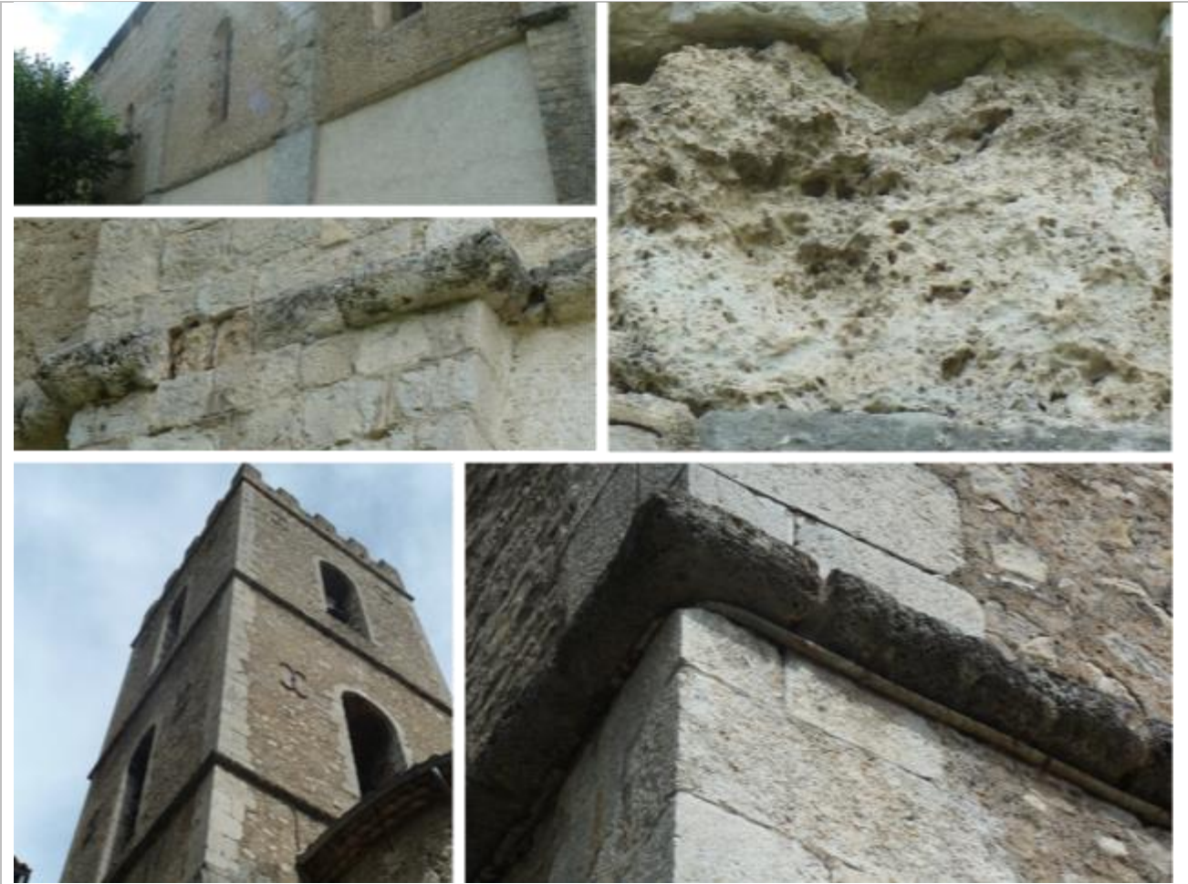
Vues de mise en œuvre du tuf calcaire beige vacuolaire, à patine grisâtre.
