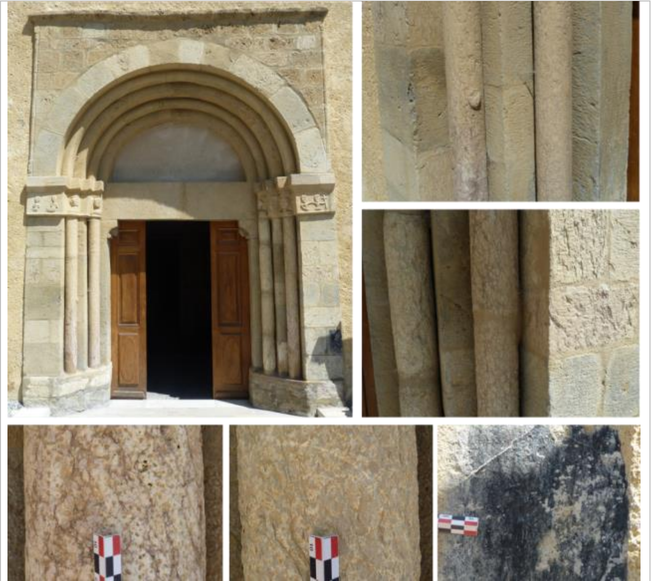
Vues du portail ouest en Marbre de Serenne rouge ou beige-vert en mélange avec un calcaire marbrier noirâtre à veines blanches de calcite, recouvert d'un badigeon jaunâtre.
