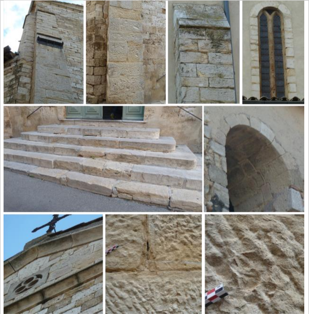
Vues extérieures de mise en œuvre du calcaire légèrement marneux jaune ou gris (parfois bicolore) à grain très fin et patine grisâtre.
