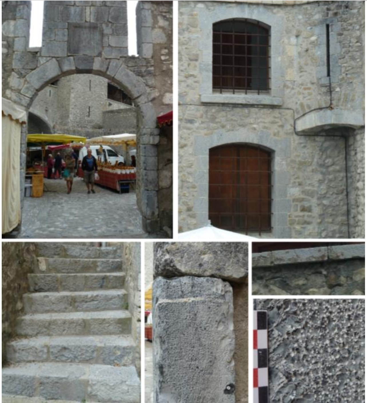
Vues de mise en œuvre du calcaire dur noirâtre à pâte fine (marbrier) entrecoupé de veines éparses blanches de calcite.
