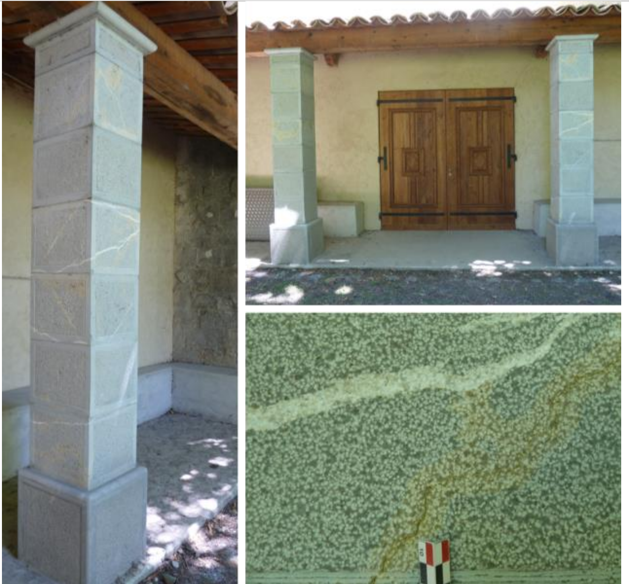
Vues des deux piliers (restauration récente) en calcaire dur gris à grain très fin, parcourus de veines blanches de calcite et de veinules jaunâtres plus argileuses.
