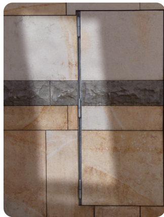
Armoire intégrée Habillée avec le matériau de finition de la façade
