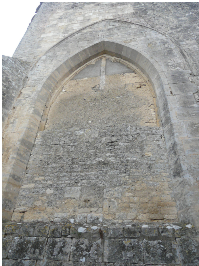
À l'extérieur, les pierres du mur gouttereau Sud sont altérées et les joints sont en creux.
