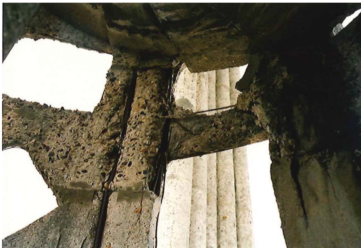
Dégradations du béton (1996)
