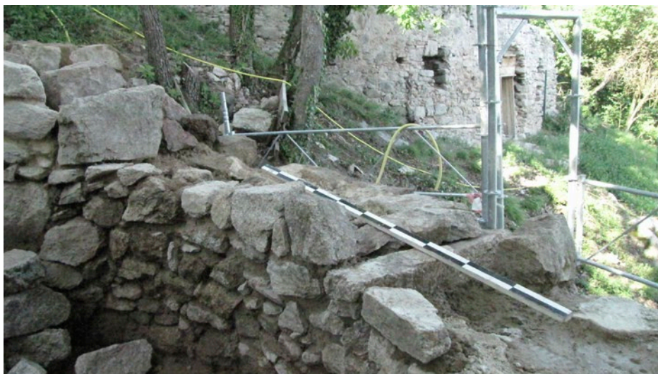
SCHERWILLER, château du Ramstein Partie sommitale en cours de travaux (cliché : C. FREY)
