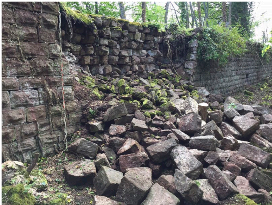
MOLLKIRCH, château du Guirbaden Mur M01 : brèche parement extérieur avant travaux (cliché : G. PERALS)
