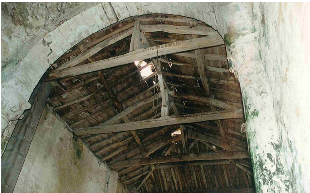
Arc doubleau de l'entrée du chœur - Vue sur la charpente de la nef haute.
