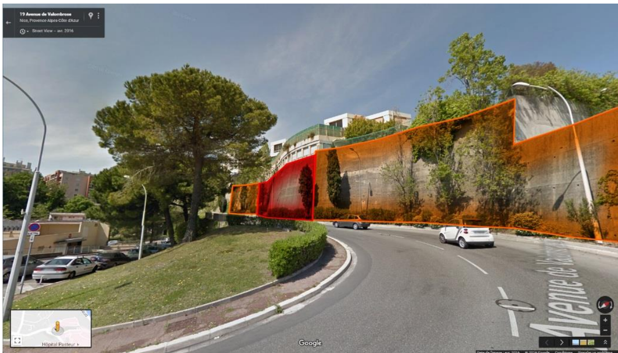
Vues depuis l'Avenue de Valombrose du mur de parement(rouge)/soutènement (orangé), avec le bâtiment K au Nord-Ouest surplombant le dit-mur et l'avenue. Source Google Street view.
