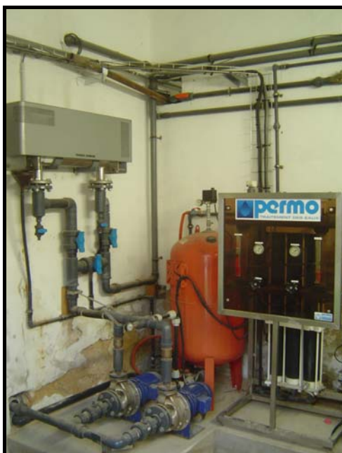
Osmoseur, UV et surpresseur
