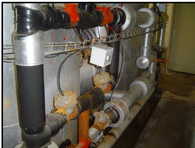
Filtres à sable et panoplie
