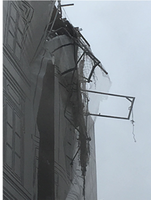
Vue du pan du mur qui s'est écroulé
