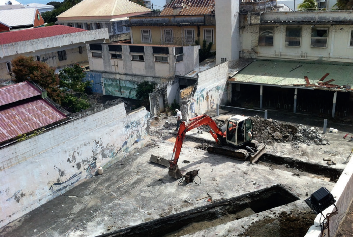
[Fig.23g] : Diagnostic de la cour nord-est
