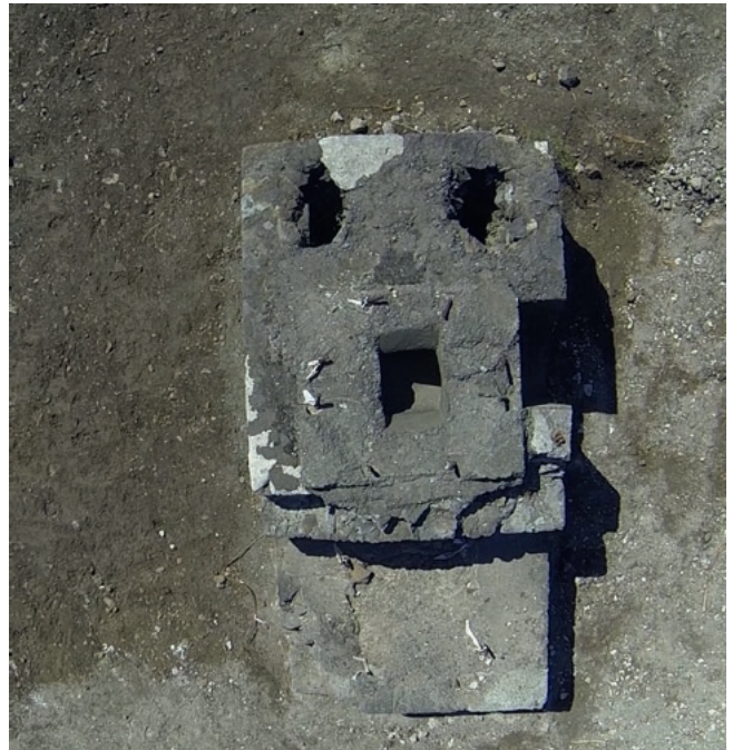
[Fig. 15i] : Vue aérienne du support de machine MAC 103
