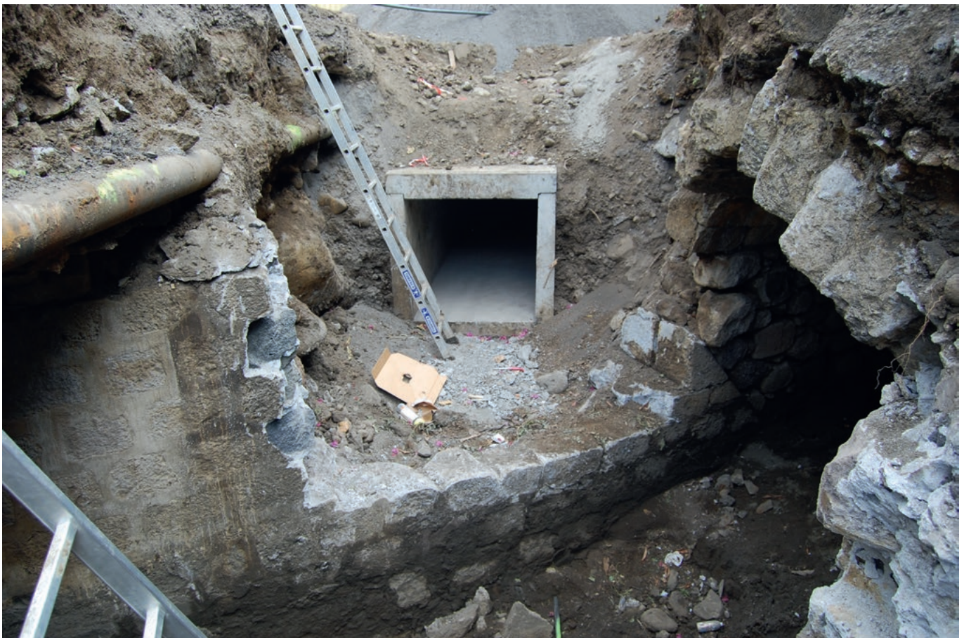
[Fig. 19a] : Vue de l'ouvrage souterrain éventré sous la Grande Montée
