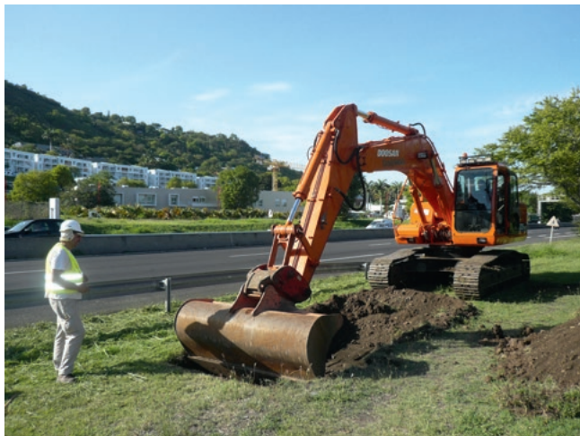
[Fig. 10a] : Diagnostic le long de la RN1
