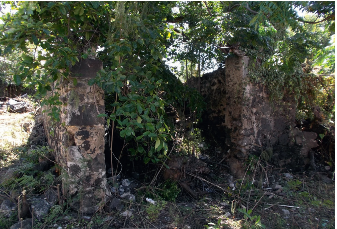
[Fig. 37b]: Vue du bâtiment en ruines de l'entrepôt depuis la terrasse inférieure
