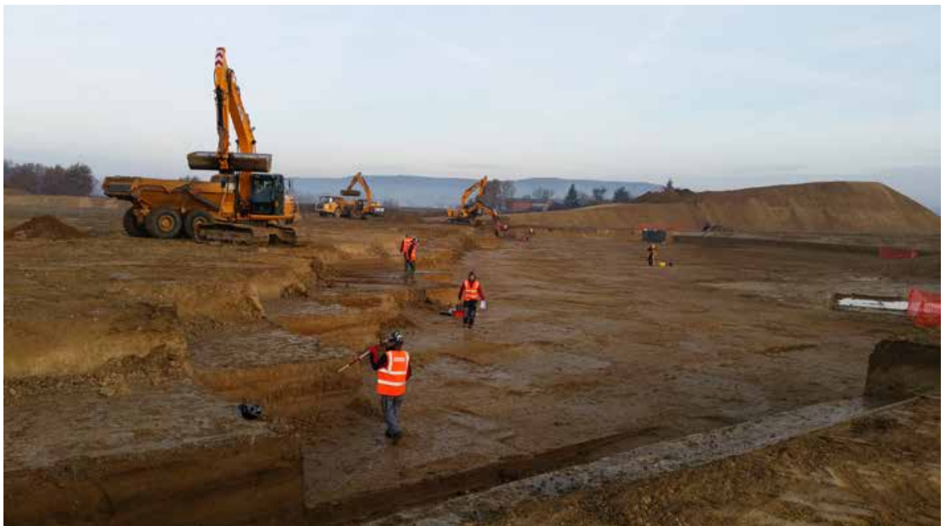
Saint-Sulpice, Le Bois de l'Hôpital. Site en cours de fouille, au centre le secteur 0, tranche 1 (© SPLA Les portes du Tarn).
