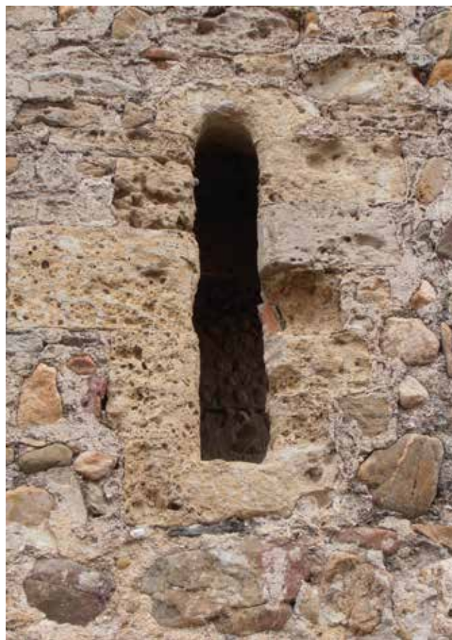
Fig. 3 : baie médiévale réalisée en calcrète (tuire local) au XII e s. dans l'église ruinée de Nyls, dominant la Canterrane, au cœur de la plaine du Roussillon (cliché C. Respaut).
