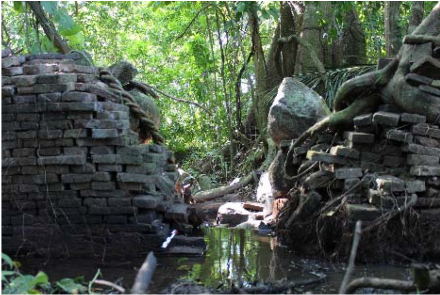
Figure 7 Zone arrachée du barrage poids
