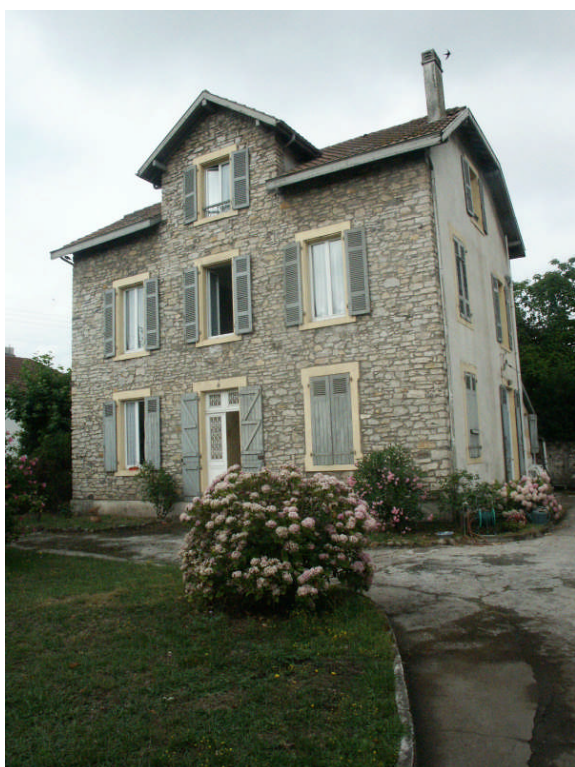
Les maçonneries, constituées de moellons, sont destinées à être enduites. Les encadrements de pierres sont généralement disposés en surépaisseur du moellon de manière à permettre à la couche d'enduit de venir au nu de l'encadrement ou en très léger retrait.
