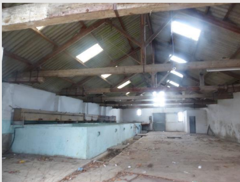
Photographie 29 : Ancienne civellerie à Paimboeuf, rue Pitre Chevalier. A gauche, les anciens bacs à civelles, 2014. © Anatole DANTO.
