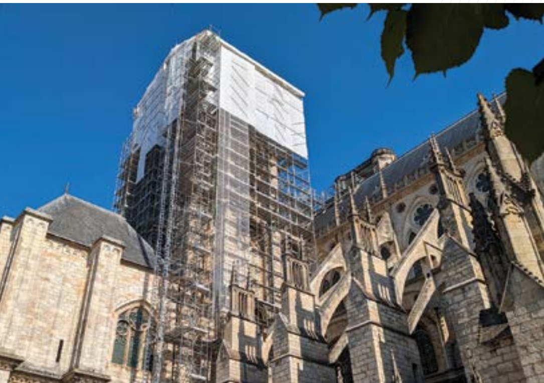
^ Chantier de couverture de la tour sud, 2023 | cliché DRAC Centre-Val de Loire.
